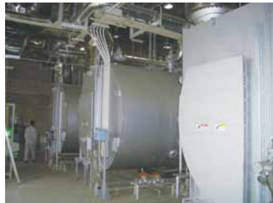
附属病院にある大型ボイラー
