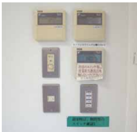
エアコンコントローラー付近のラベル
