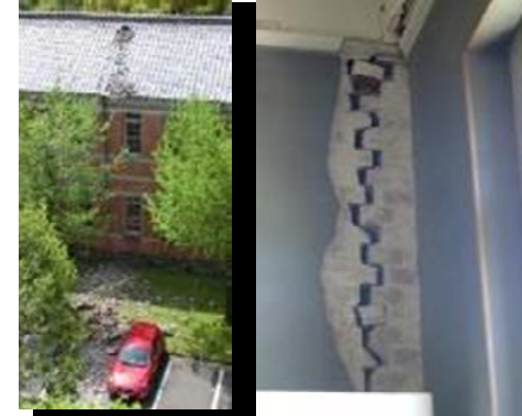
五高記念館の煙突倒壊、内壁割裂
