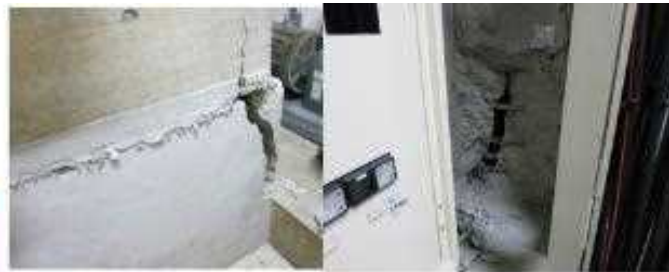
発生医学研究所 内壁ひび割れ・剥落
