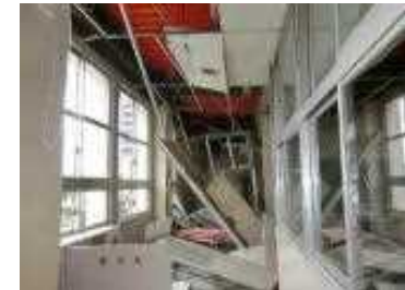
附属小学校廊下 天井崩落・壁倒壊
